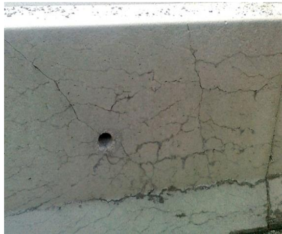
Şekil:2 Karayolu Yol Bariyerinde Gözlenen ASR Çatlakları (Bolu)
