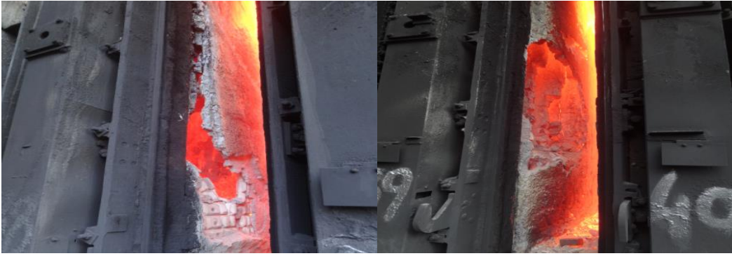
Şekil 3: Hasarlı Fırın Duvarları
