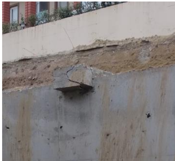
Şekil 2. Duvar gövdesine bağlanan betonarme kirişlerin eğilme etkisi ile çatlaması
